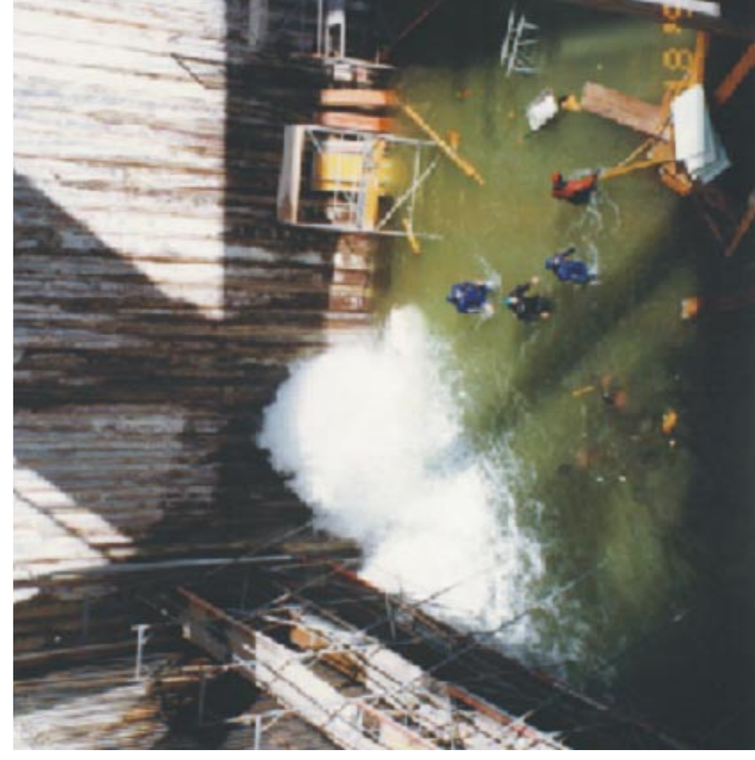
Bild 1: Plötzlicher Wassereintritt an der Anschlussstelle Wand/Sohle einer tiefen Baugrube
