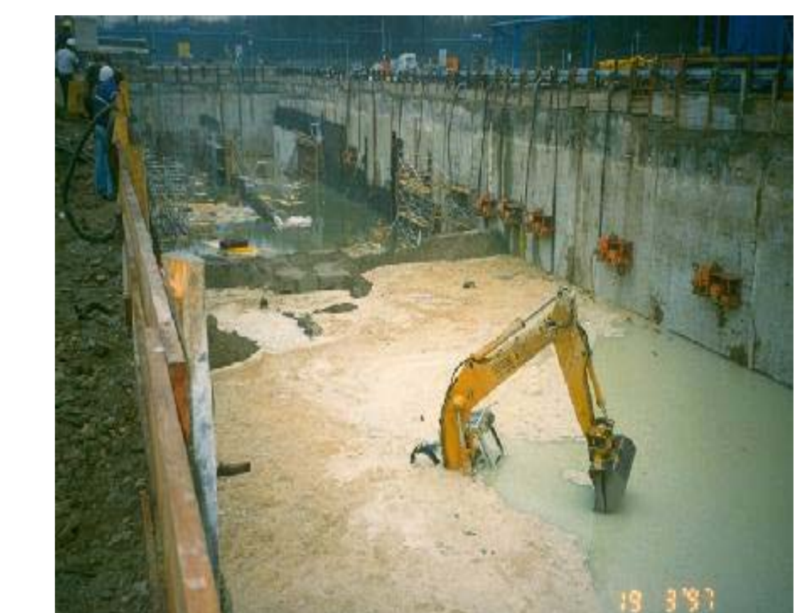
Bild 3: Havarie im Tiefbau
